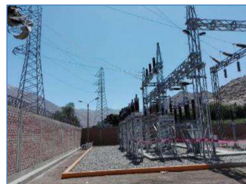
Torre de Llegada a S.E. Andahuasi
