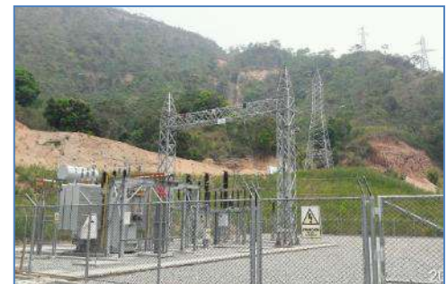
Vista de Subestación Renovandes H1
