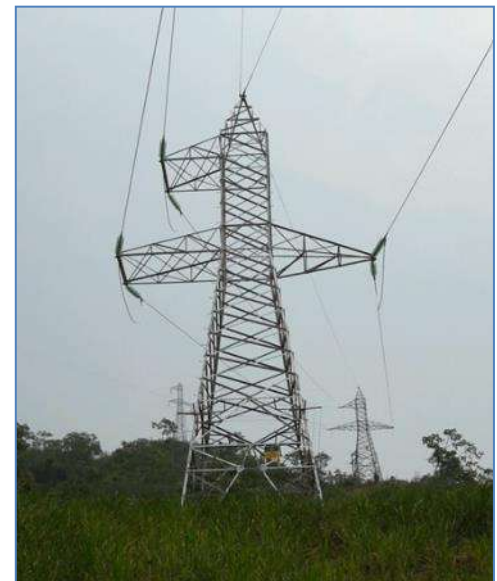
Estructura de salida de S.E. Renovandes H1
