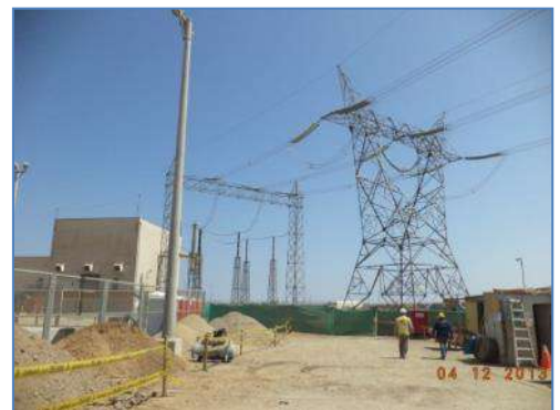
Pórtico de Salida y Subestación GIS 500 kV
