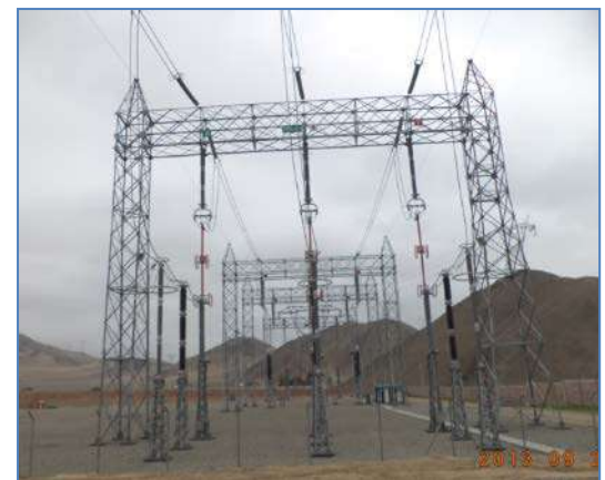
Patio de Llaves - S.E. Santo Domingo de los Olleros
