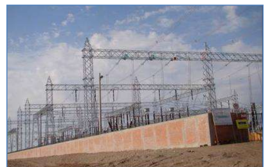
Subestación San José
