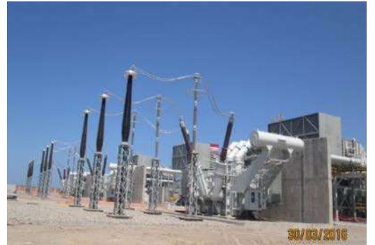
Transformadores de Potencia
