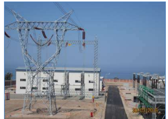
Patio de Llaves y Subestación Puerto Bravo
