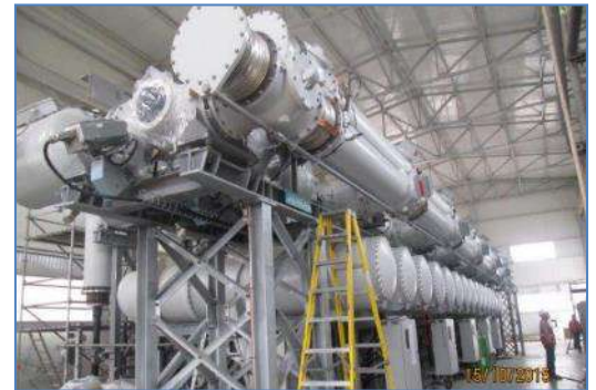
Subestación GIS - C.T. Puerto Bravo
