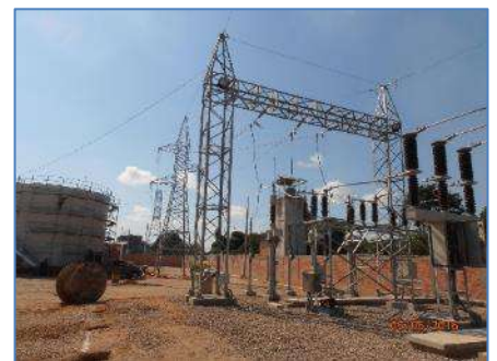
Subestación de Salida en 60 kV C.T. Pucallpa
