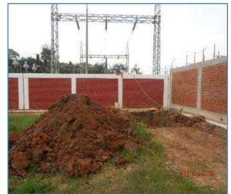
Subestación Puerto Maldonado de Electro Sur Este
