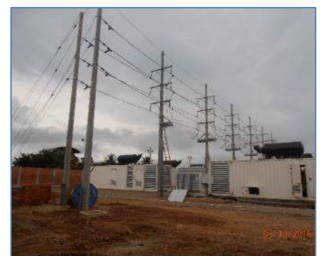
Conexión del sistema de barras en 10 kV con la SE Puerto Maldonado de Electro Sur Este
