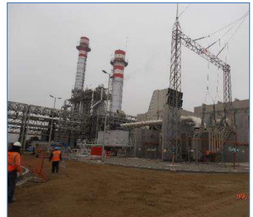
Transformador de potencia asociada a la TG
