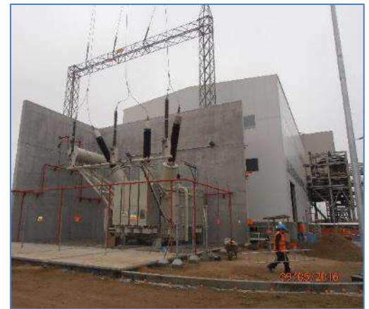
Transformador de potencia asociada a la TV
