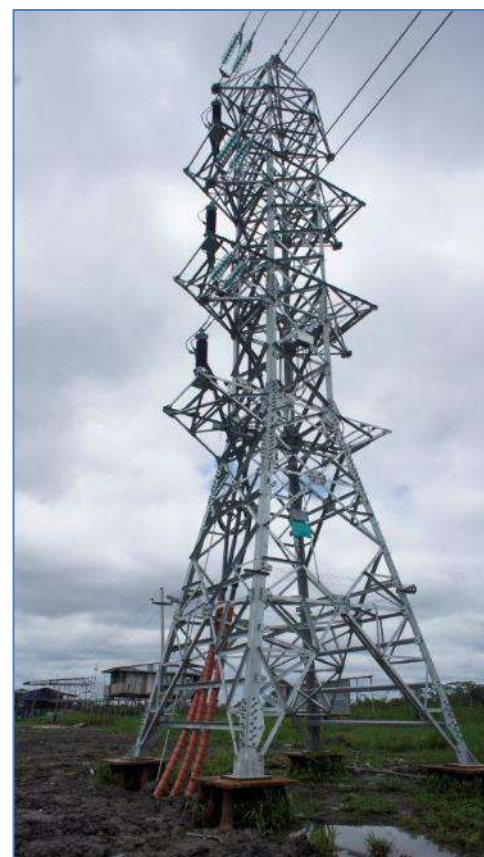
Torre de transición del tramo aéreo al subterráneo
