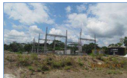
Subestación de salida
