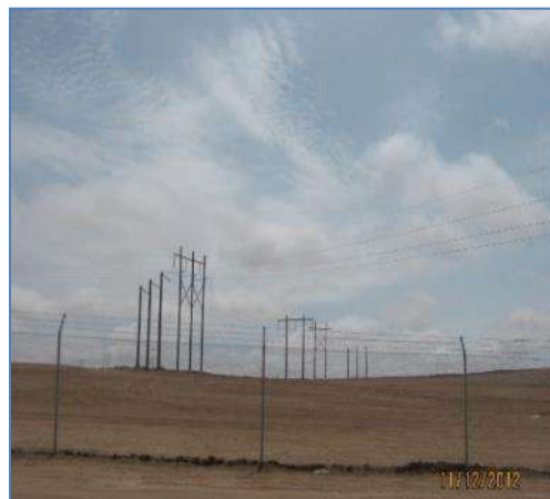
L.T. 138 kV C.S. Panamericana Solar 20 TS – S.E. Ilo 3
