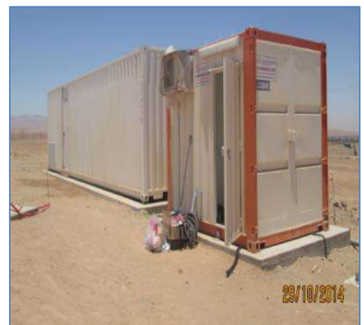
Casa de Control - P.S.F. Moquegua
