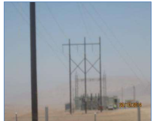
L.T. 22,9 Moquegua FV - S.E. Panamericana Solar
