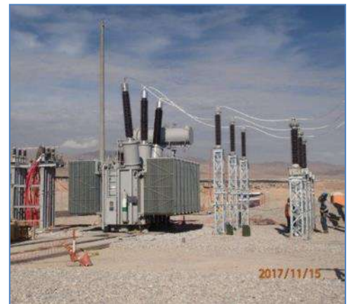
Transformador de Potencia
