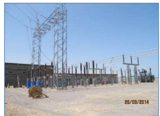
S.E. Parque Eólico Marcona
