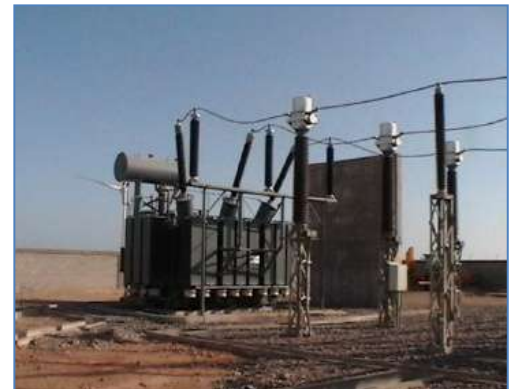
Transformador de Potencia de 35 MVA (20/220 kV)
