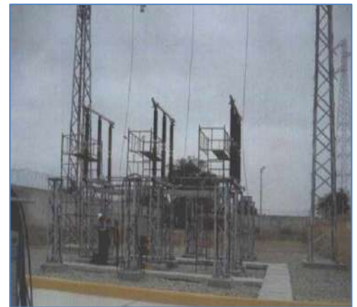
Pruebas eléctricas al seccionador de línea
