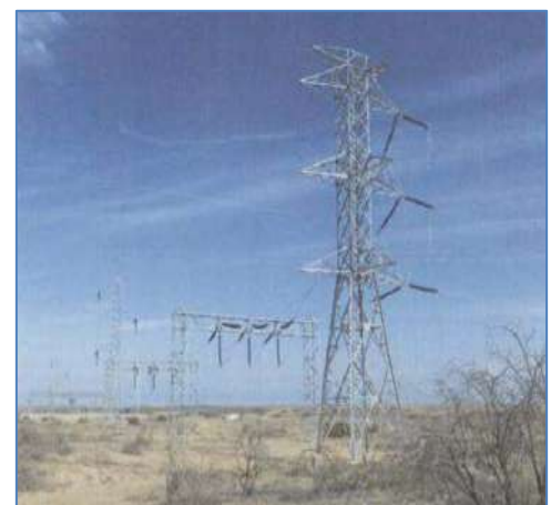
Vista de Línea de Transmisión L-2161
