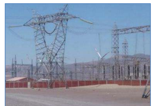
Pórtico de Llegada S.E. Poroma
