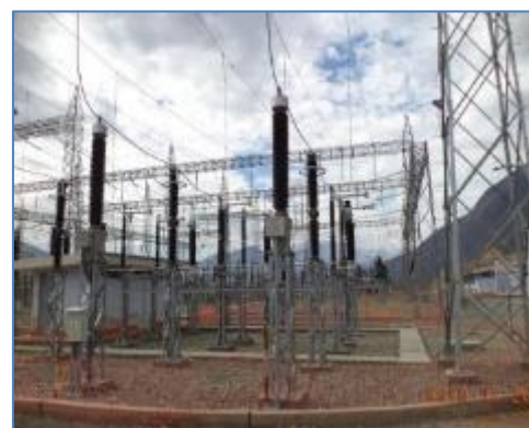
Celda de Conexión, S.E. Concepción
