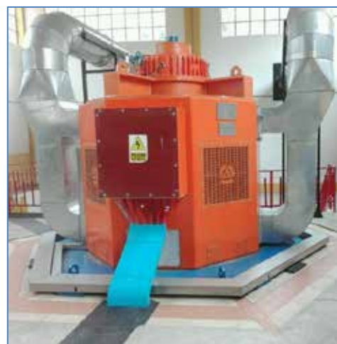
Equipos Turbina - Generador
