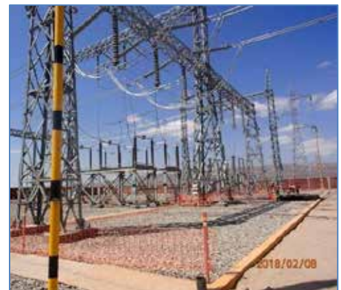
Patio de llaves de la S.E. Flamenco
